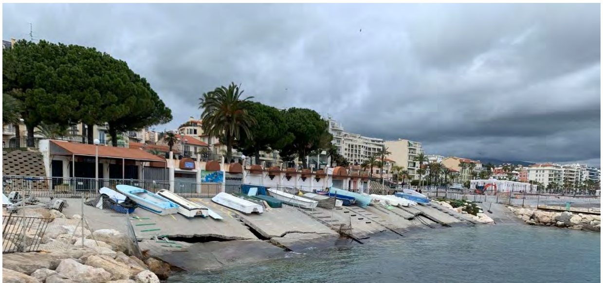
Cales de halage cassées et bâtiment en arrière-plan
